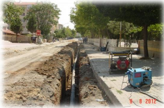
ALAN SOKAK İÇMESUYU ANA HATTI
